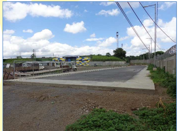
Panorámica de la pista de calentamiento donde se aprecia la finalización de la imprimación de asfalto, iluminación y andenes.
